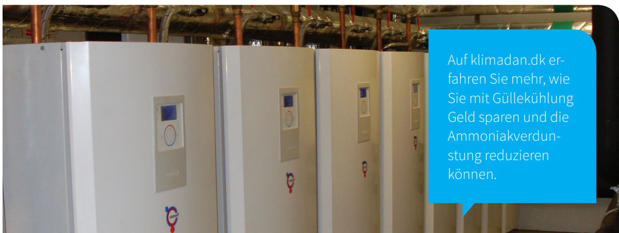
Kaskadengekoppelte Wärmepumpen sind das Herzstück einer Güllekühlungsanlage.
