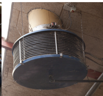
Staldvarmeanlæg i svinestald
