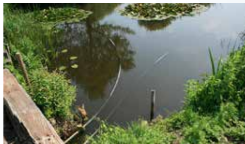
Figur 6.16. Søvandsanlæg (slanger i søen).
